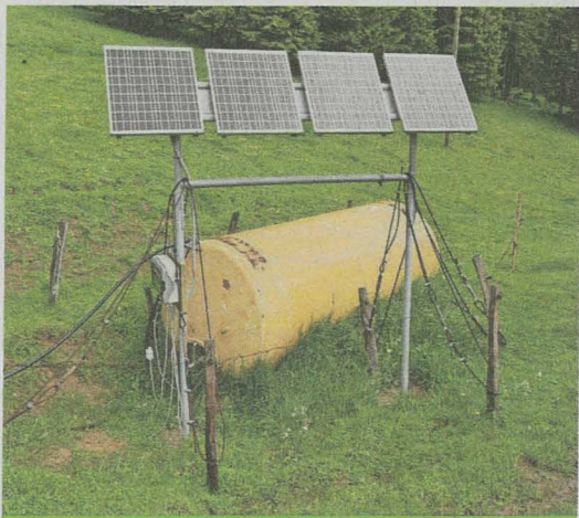
Les pompes à eau solaires sont une solution pratique sur les alpages.
