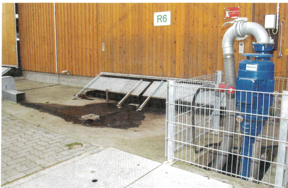
Querkanäle und Vorgrube lassen sich so anordnen, dass die Gülle gefahrlos hineingelangen und umgepumpt werden kann. Bild: Beat Steiner
