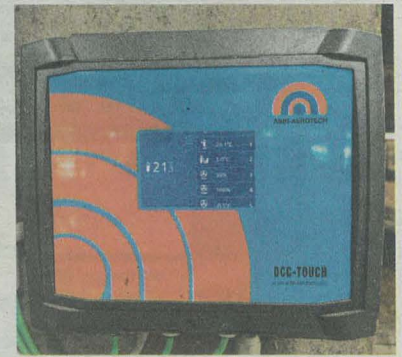
Die Steuerung der Ventilatoren sollte temperaturabhängig und automatisch erfolgen.
