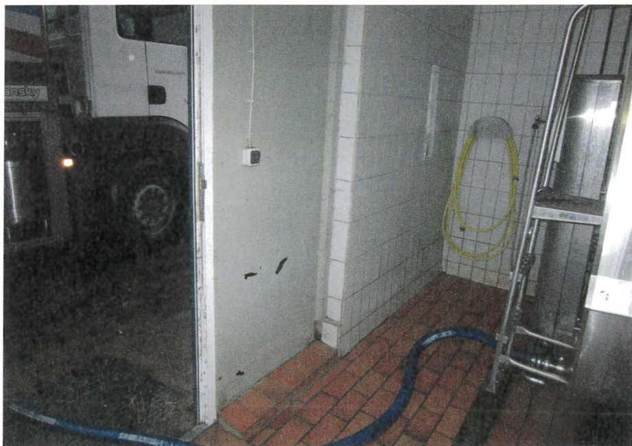
Der Absaugpunkt sollte mit einem max. 6 m langen Schlauch erreichbar sein. Die Verwendung einer betrieblichen Absaugleitung bis zum Absaugpunkt ist möglich, diese muss dann allerdings vom Betrieb in den regelmäßigen Reinigungsablauf integriert werden.
