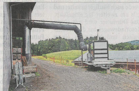
Zum Gebäude muss ein Sicherheitsabstand von acht Meter eingehalten werden.
