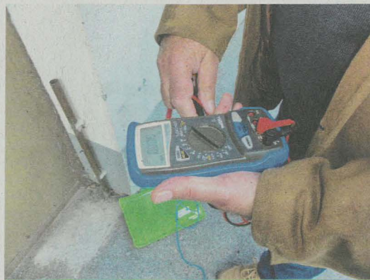
Jacques Piguet teste une mise à terre posée là dans l'espoir de résoudre les problèmes dans l'étable. M. ROMANENS
